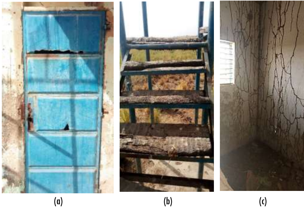
Photo 3 : Etat dégradé des miradors d'observation de l'île aux oiseaux de Bello-Tounga Prise de vue : Coffi, mars 2019
