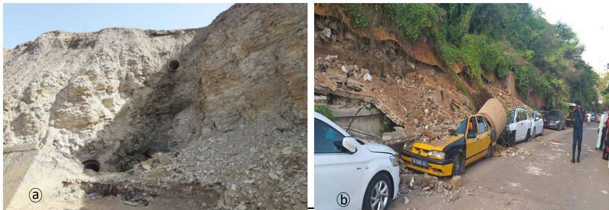
Photo 3 : (a) Conduit d'évacuation d'eau déstabilisant la falaise d'argiles de la plage de Rebeusse et (b) affaissement de la falaise qui surplomb l'hôtel Lagon 2 sur la Corniche Est
