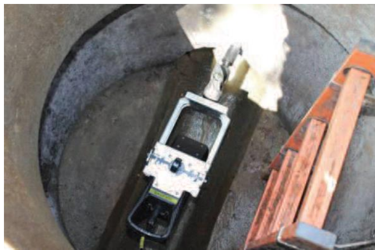
Photo 1 : Débitmètre dans un regard à l'exutoire
