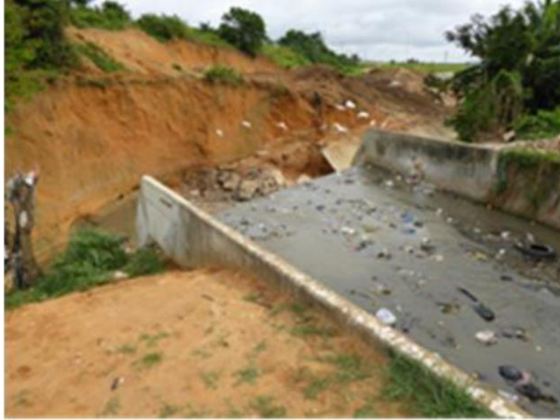
Photo 6 : Rupture de canal principal au Carrefour Williamsville
