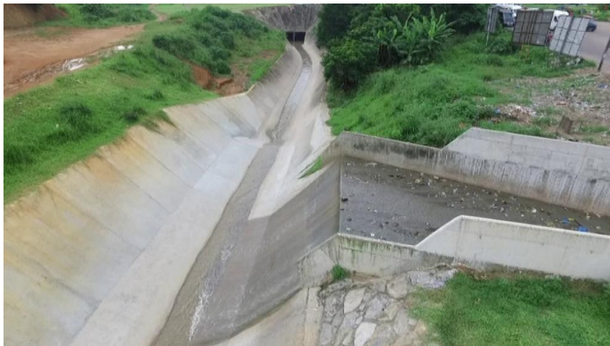
Photo 5 : Raccordement d'effluents urbains sur le réseau d'eau pluviale
