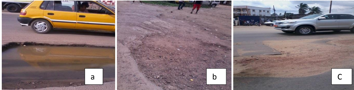
Figure 2 : Dégradations présentes sur la nouvelle route (NR) : a) Nids de poule sur la nouvelle route, b) ressauge, c) Arrachement
